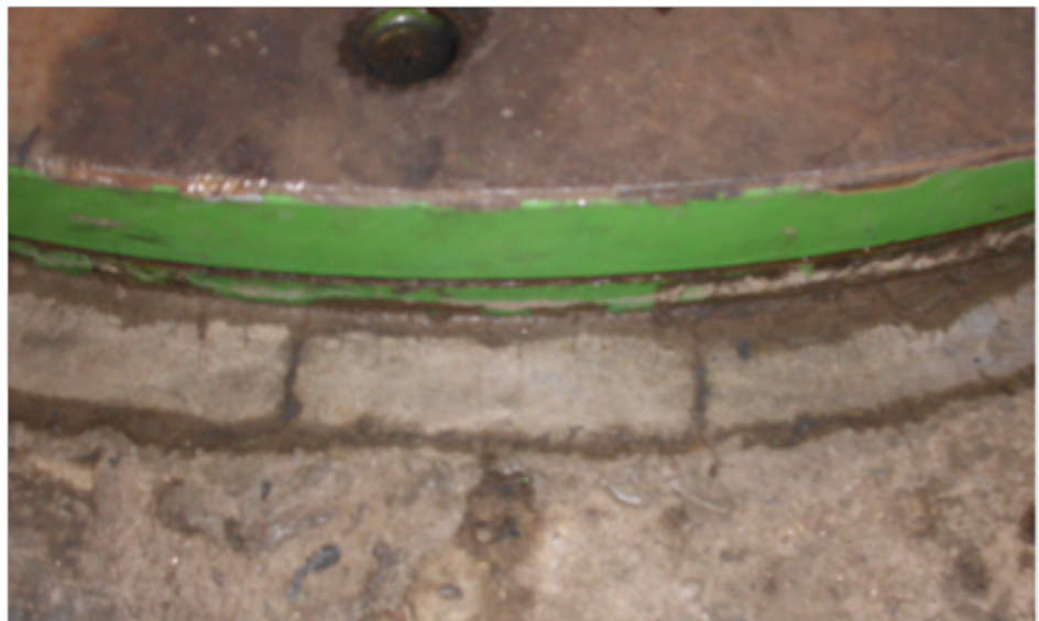
Foto 3.-Detalle grietas en bancada
